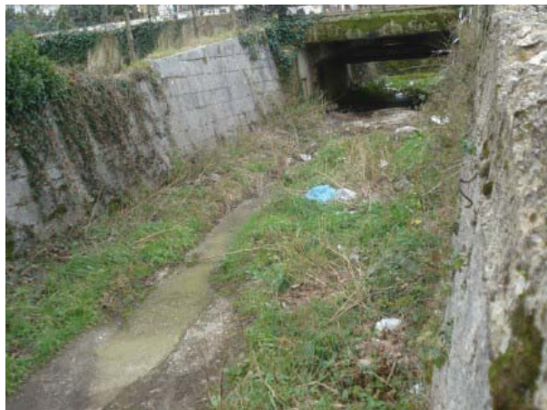
Foto I – opera di attraversamento lungo il tratto del torrente Conca che attraversa il centro urbano di Cervinara (AV).
